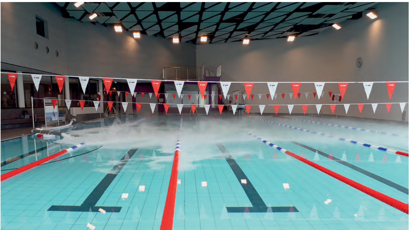
① Luftführung in einem Hallenbad, hier untersucht mit einem Nebelgerät.
